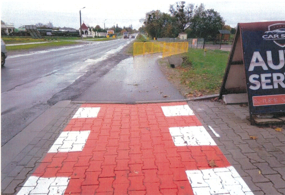
Wyjazd z posesji przy serwisie samochodowym (wysokie krawężniki oraz malowanie farbą która powoduje że nawierzchnia jest bardzo śliska.
